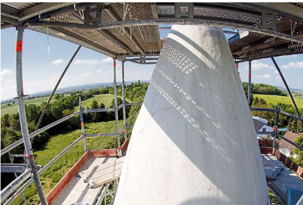
Der Erbenheimer Wartturm am Fort Biehler ist seit über einem Jahr von einem Gerüst umgeben, ohne dass sich darauf etwas regt. Archivfoto: Sascha Kopp
